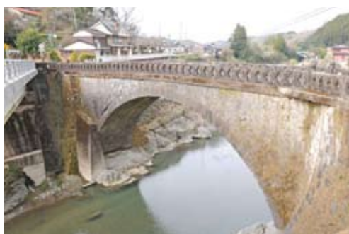
洗玉眼鏡橋の上流側に県道橋(左端)が架かっている 石橋の左岸側の壁石に亀裂とふくらみが見られる
