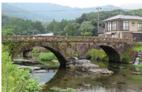
大園橋の上流側水切り石前には、金網のかごに石を詰めた蛇籠（じゃかご）が設置されている 写真提供／小手川清隆
