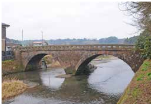
下流側からの大園橋。2連の輪石が接する中央の「袴石」が欠落した状態 写真提供/中村まさあき
