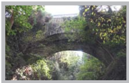
須崎橋(福岡・八女市) 橋台基礎が破損したため、架け替えられている。写真は2010年の在りし日の姿
