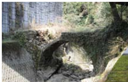
岩下橋(熊本・菊池市)* 右岸側の壁石が損壊し輪石がむき出しになった(1.29)
