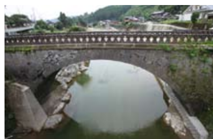
洗玉橋（福岡・八女市／市指定文化財） ひ・ふ・み・よ橋の「ひ」、単アーチ。壁石に痛ましい損傷が残る（昨年8.12）
