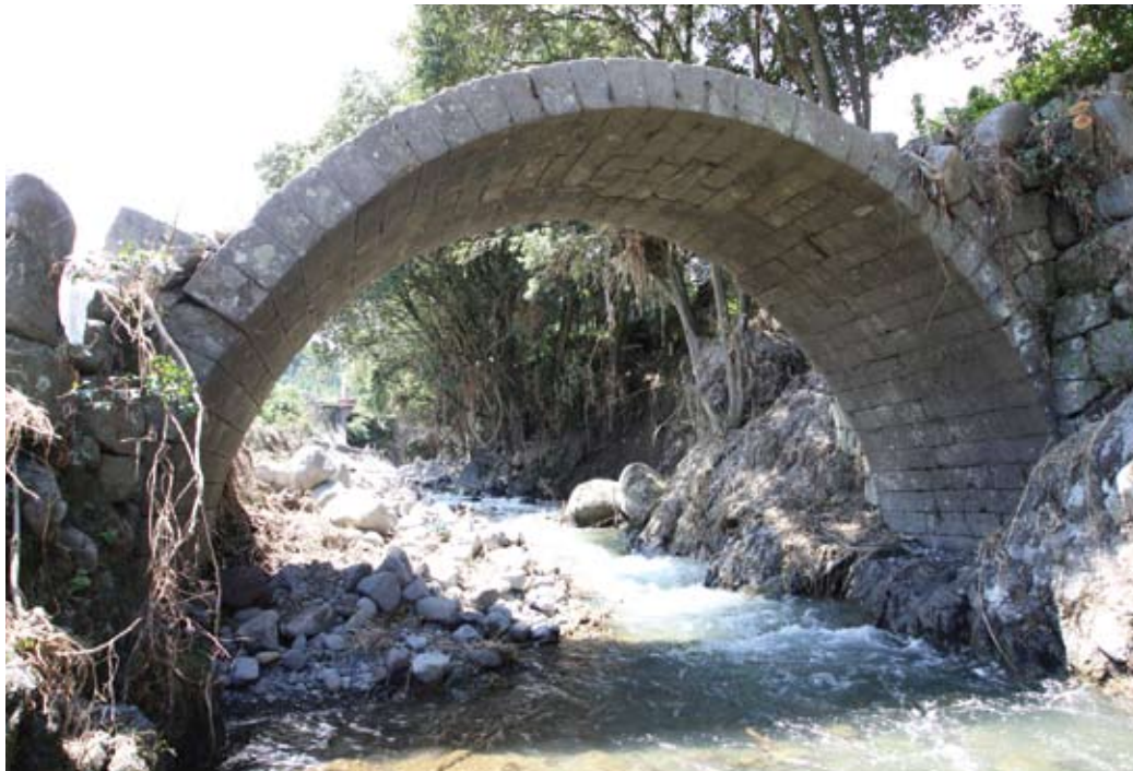
筏場眼鏡橋(大分・日田市／県指定文化財) 大分県内現存最古のめがね橋は、右岸側取付護岸、壁石などが流失し、輪石のみの姿となっていた。撮影／賛田 岳和(昨年7・28)
