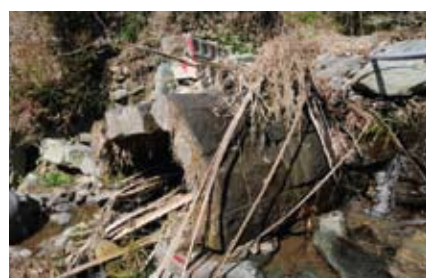
関屋橋(福岡・八女市/市指定文化財)* 壁石も取付護岸も流失し、ずれて変形した輪石のみが辛うじて残った(2.3)
