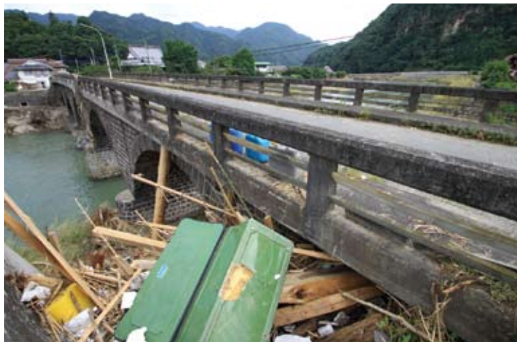
馬溪橋(大分・中津市/市指定文化財) 激流に耐えた5連アーチだが、石橋が2度の浸水被害の要因と、地元の住民からコンクリート橋への架け替えの要望が市へ提出されている(昨年7.8)
