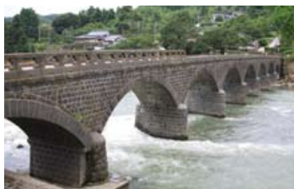
耶馬溪橋(大分・中津市/県指定文化財) 8連アーチ橋。勾欄の一部が流失(昨年7.8)
