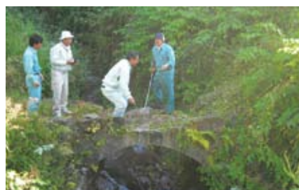
川内田堀切橋現地調査。周辺には草が生い茂り、アーチ中央部分の壁石は流失していた（昨年10.13）
