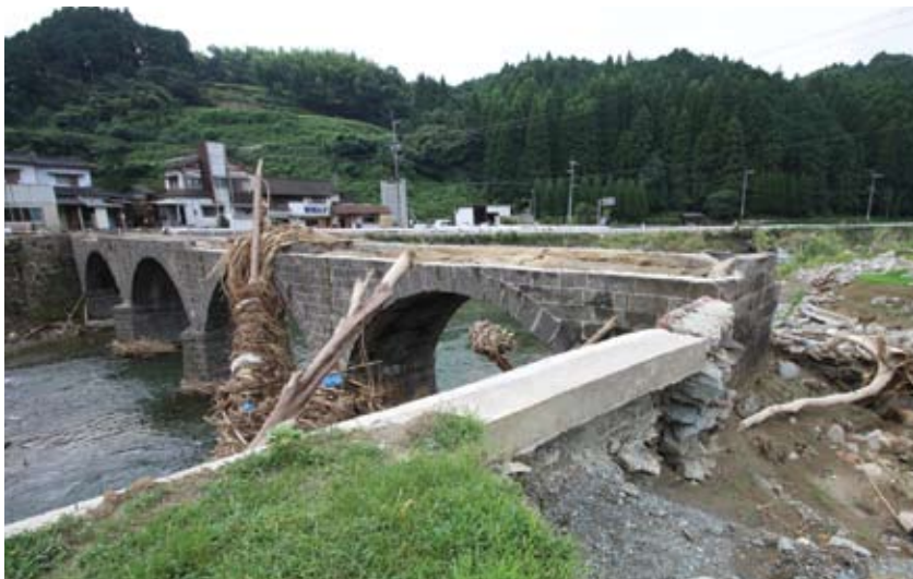
宮ヶ原橋（福岡・八女市） ひ・ふ・み・よ橋の「よ」、4連アーチ。川の水位は路面を超え、勾欄と路面下の中詰め土砂が流れ出て、右岸側の取付護岸は大きく破損した（昨年8.12）
