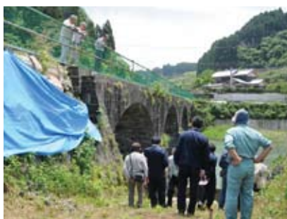
洪水に耐えた宮ヶ原橋(上陽町)
