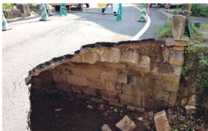
豪雨被害後の小巖橋(2014年7月)。下流側の輪石が崩れ、勾欄(こうらん)も流失している(*a)
